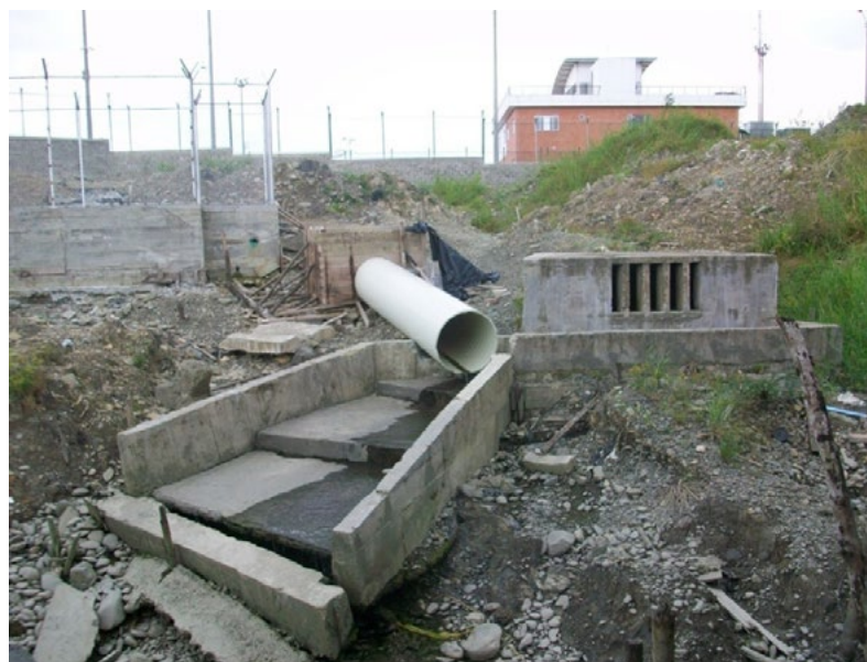
Desagüe de TCBUEN en el alcantarillado del barrio de Santa Fe
